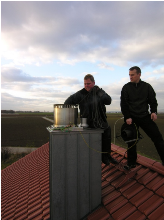
Abbildung: Der zuständige Kaminkehrer Markus Eckl (links) und Arild Nesse von der Firma APP aus Norwegen (rechts) bei der Inbetriebnahme eines auf einem Schornstein aufgebauten elektrostatischen Abscheiders zu Beginn des Feldversuches
