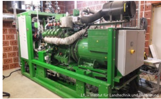
Substitut von Erdöl und Erdgas: Strom und Wärme aus Biogas
