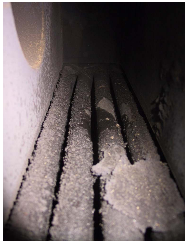
Abbildung 5: Ablagerungen auf der ersten Ebene der Wärmetauscherrohre (Betrieb mit Holzhackschnitzel)
